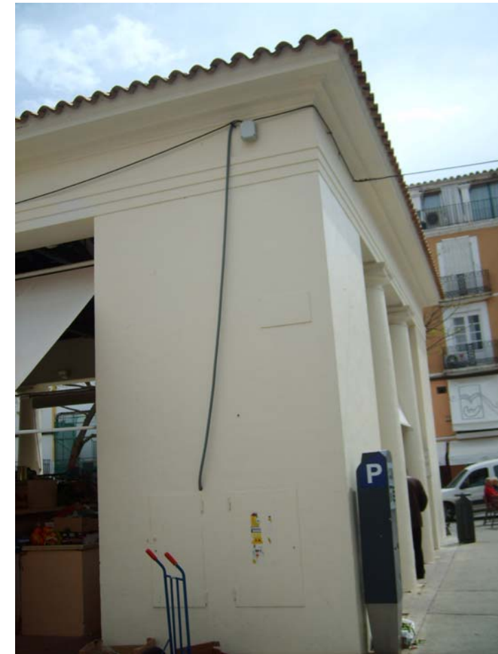
Debe limitarse y protegerse la instalación eléctrica al exterior.
