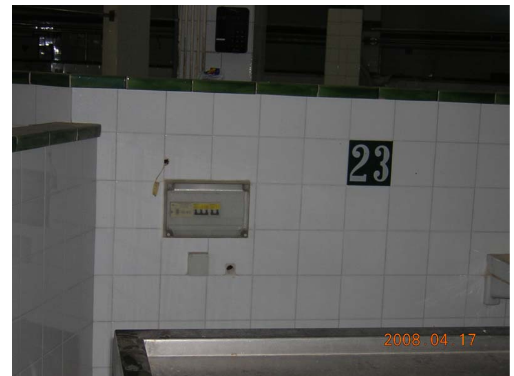
Instalación eléctrica de puestos totalmente obsoleta.
