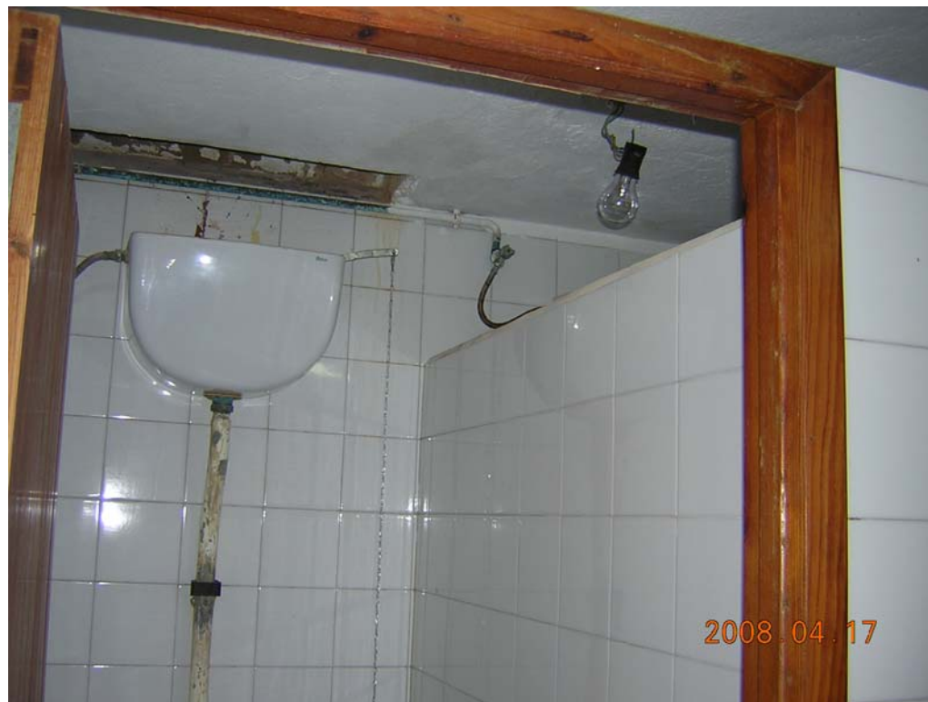
Los aseos y otros servicios son inadecuados.
