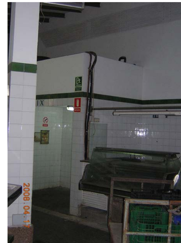
Instalaciones en precario estado (Electricidad, frío, protección contra incendios, etc.)
