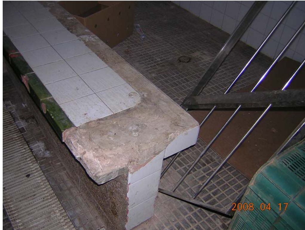
Algunas partes de la sala se encuentran ruinosas.
