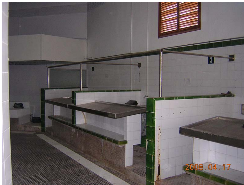
Los puestos están sin uso y con distintos grados de deterioro.
