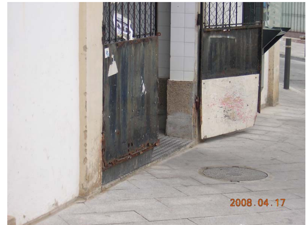
La cerrajería se encuentra en malas condiciones.
