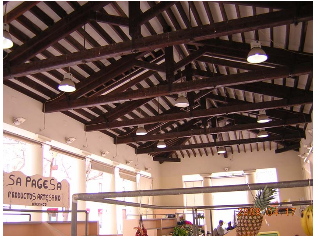
La iluminación general interior es adecuada, sin embargo no existe iluminación propia de puestos ni para la exposición de productos.
