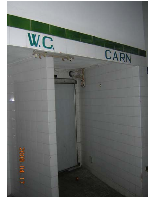
Área de cámaras con importantes carencias higiénico-sanitarias.
